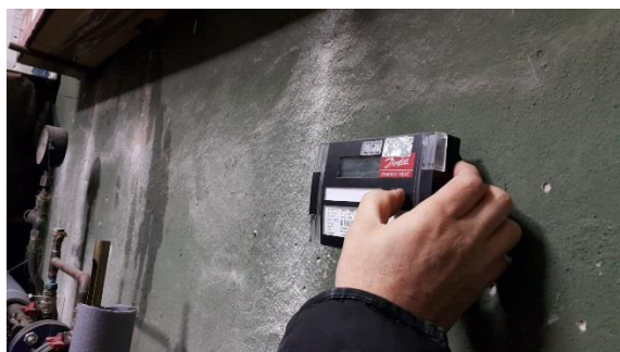
Piebūvē esošais siltummezgls ar siltumenerģijas skaitītāju
